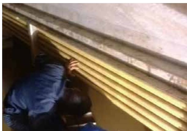
使用专用阻垢剂后的换热管
